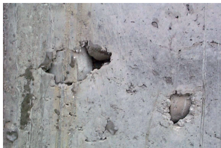
Рис. 1. Зависание бетонной смеси в зоне «сухарей»
