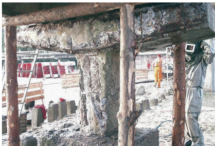
Рис. 3. Разрушение бетона маломассивной опоры с оголением и коррозией арматуры
